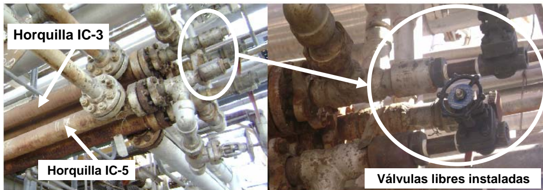
Figura N° 3.4. Modificación de la entrada de agua de los equipos IC-3 y 5 (Elaboración propia).
