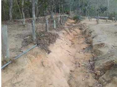
Figura 91: Caminería interna de “Sabas Nieves II” profundamente deteriorada
