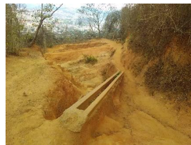
Figura 16: Canal de drenaje expuesto por la erosión vía “Sabas Nieves II”
