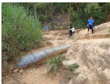
Figura 17: Tubería expuesta por la erosión en el sendero “Sabas Nieves I” - “Sabas Nieves II”
