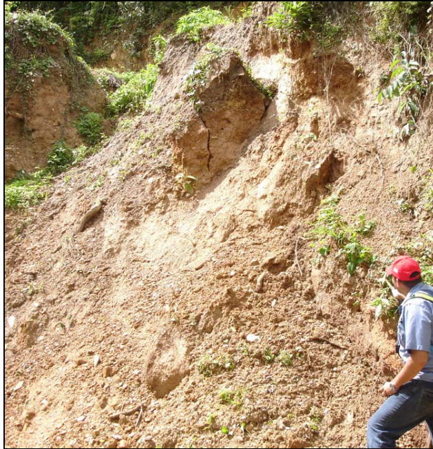
Figura 16: Proceso activo de Remoción en masa en talud. Coluvión en ladera. Foto con Azimut de 20°.
