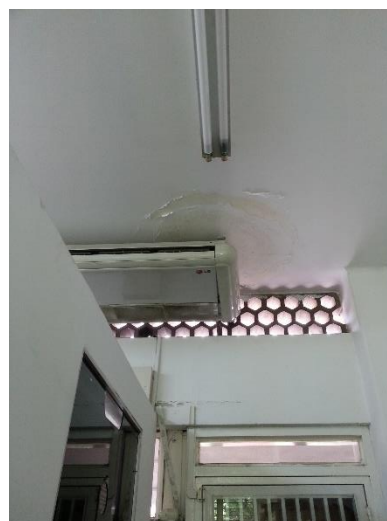
Anexo A. 2. Humedad en losa de techo entre ejes B-C y 5-7. Módulo de Aulas.
