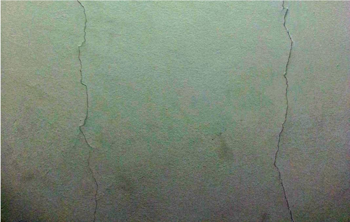
Figura 28. Grieta por separación pared-columna. Fuente: Fotografía capturada el día 26-05-2015
