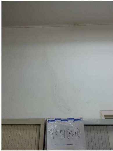
Anexo A. 9. Grieta vertical en pared 17 (M-N). Módulo de Dirección.
