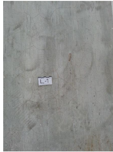
Anexo A. 10. Fisuras interconectadas en columna L1. Módulo del Herbario.
