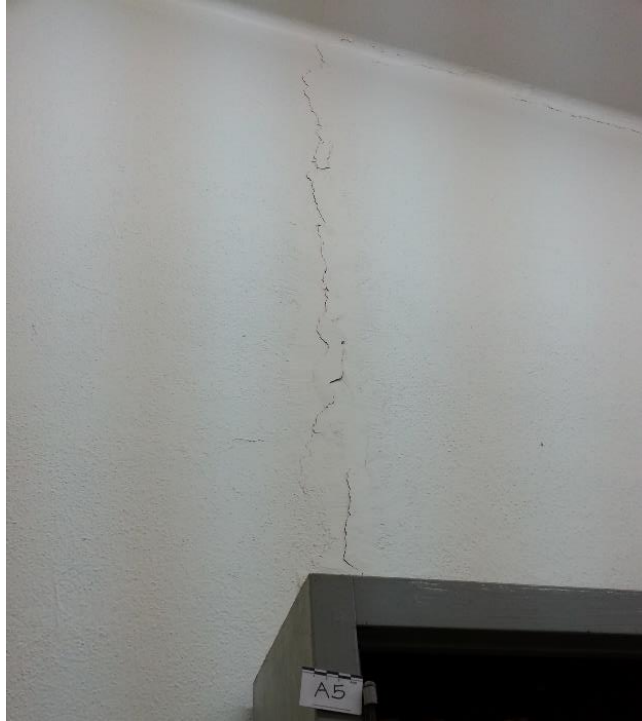
Figura 21. Grieta separación pared-columna y pared-viga. Fuente: Fotografía capturada el día 26-05-2015.
