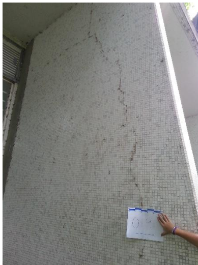
Anexo A. 11. Grieta en mosaicos del parasol O-9. Módulo del Herbario.
