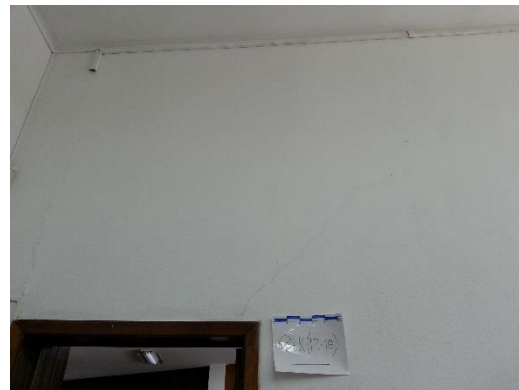
Anexo A. 8. Grieta a 45° en pared K (17-18). Módulo de Dirección.
