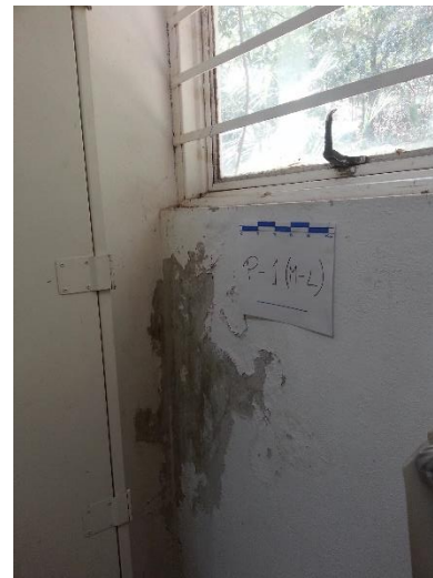
Anexo A. 12. Humedad en pared 1 (M-L). Módulo del Herbario.
