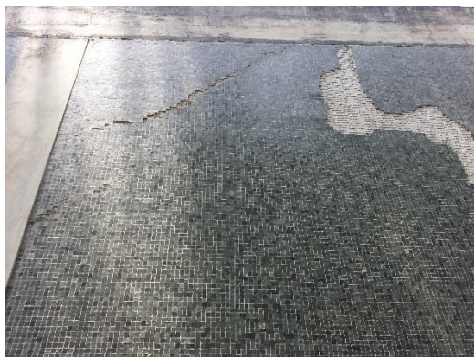
Anexo A. 3. Grieta a 45° y desprendimiento de mosaicos en pared A (3-5). Módulo de Aulas.
