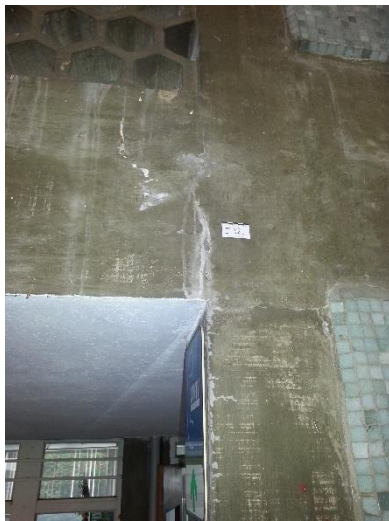
Anexo A. 15. Grieta y humedad en nodo de columna I12. Sistema de corredores.
