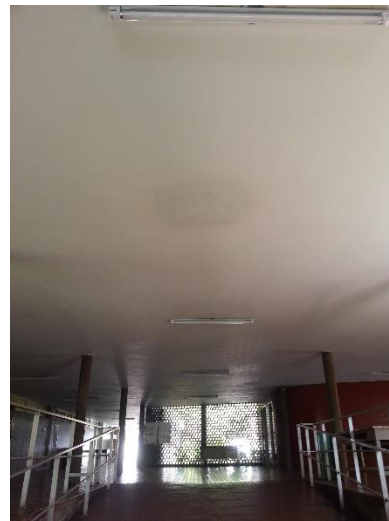
Anexo A. 16. Humedad en losa de techo entre ejes G-I y 8-9. Sistema de corredores.
