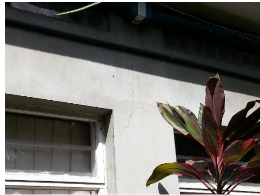
Anexo A. 14. Grieta en nodo de la columna J4. Módulo del Herbario.
