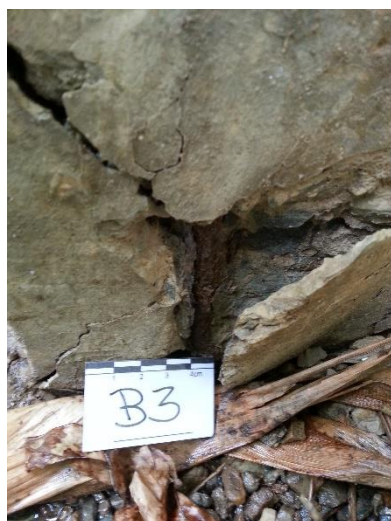
Anexo A. 1. Pérdida de recubrimiento en columna B3. Módulo de Aulas.
