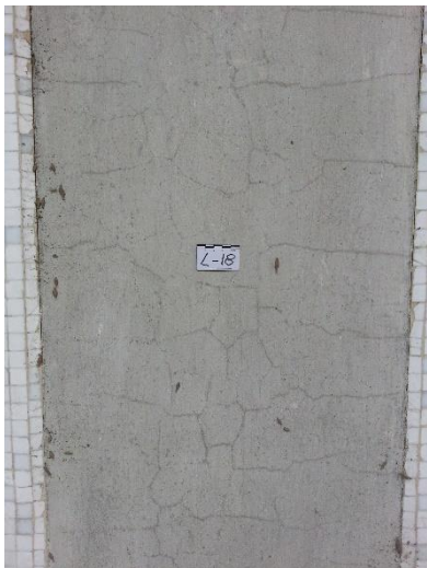
Anexo A. 7. Fisuras interconectadas en columna L18. Módulo de Dirección.
